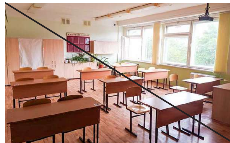
Плохо Линолеум под дерево
