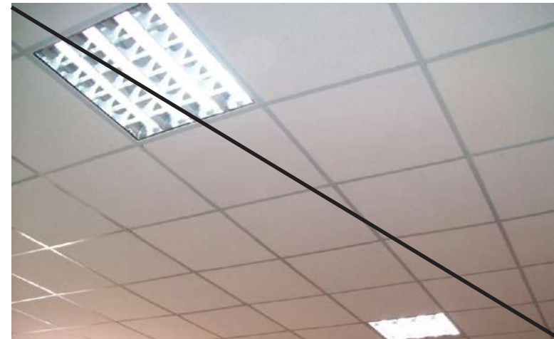
Плохо Открытые направляющие
