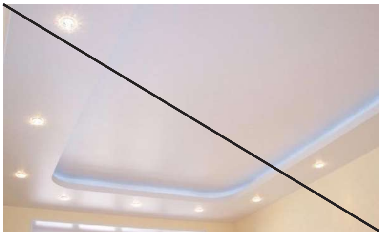
Плохо Многоуровневые гипсокартонные конструкции
